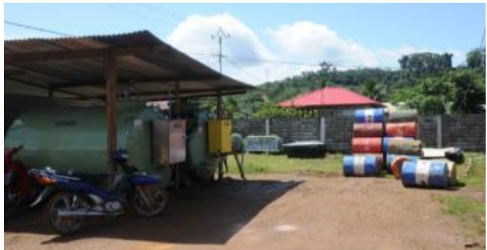
Photo 72 : Cuves équipées d'un système de distribution de carburant - centre technique de la mairie de Papaïchton
