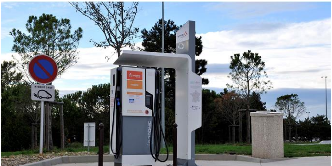
Figure 44 : Borne de recharge Sodetrel sur une aire d'autoroute (Sodetrel)
